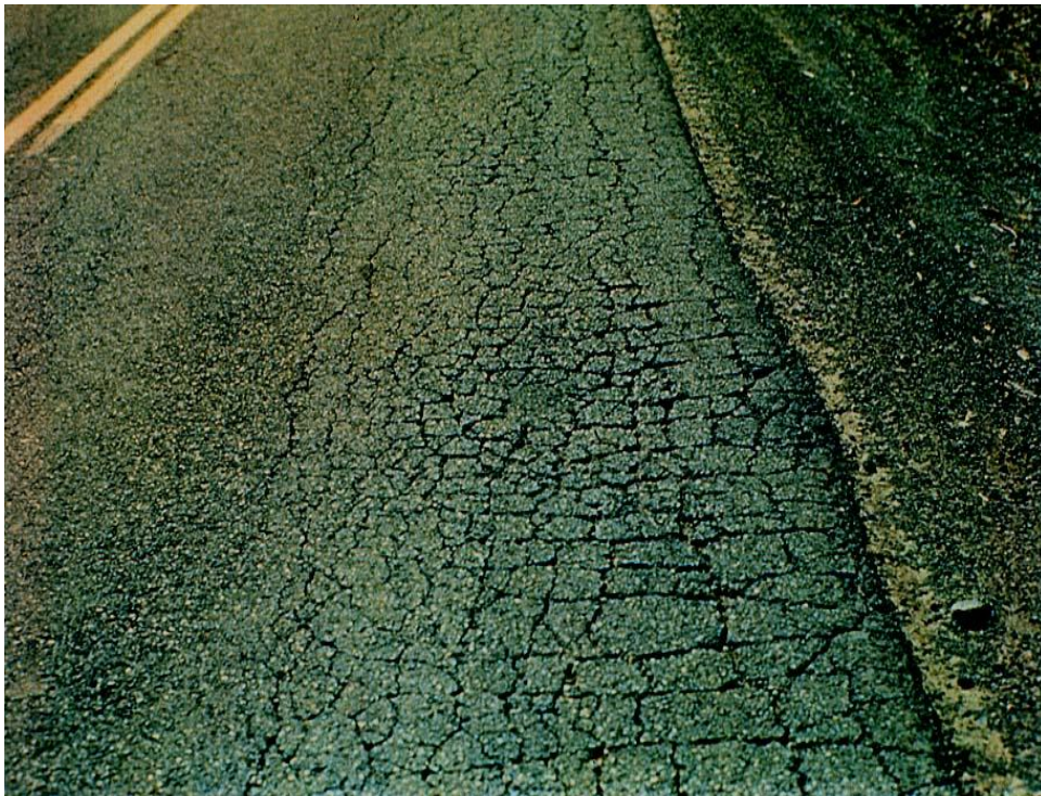
شکل ۲-۵: ترک خستگی در مسیر راه [۵۲]
